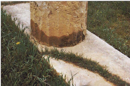
4. Ανύψωση των υδάτων του εδάφους μέσω του φαινομένου της τριχοειδούς αναρρίχησης και ανάπτυξη φυτών στις ρωγμές του μαρμάρινου στυλοβάτη.
