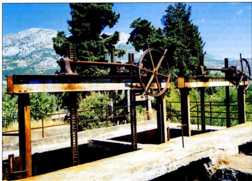
2. Υδατοφράγες στο σταθμό παραγωγής ηλεκτρικής ενέργειας της Αγγλικής Εταιρείας στην Υλίκη.
