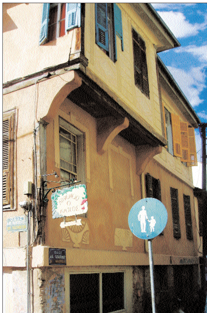
2. Άποψη του κτιρίου από την οδό Αλ. Παπαδοπούλου. Διακρίνονται οι ανάγλυφες επιφάνειες από επίχρυσμα, ένα σφραγισμένο άνοιγμα και η αποσάθρωση τωντσιμεντόπλινθων στην τοιχοποιία του ισογείου.
