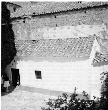
1. Η Νότια όψη του παρεκκλησίου του καθολικού της μονής της Παναγίας της Φανερωμένης. Ο βόρειος τοίχος του παρεκκλησίου εφάπτεται του νότιου τοίχου του καθολικού.
