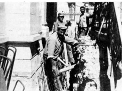
3. Εργασίες υποστήριξης κύριας όψης (όλη η σκάλα της κύριας εισόδου σηκώθηκε να γίνουν οι εργασίες και αποκαταστάθηκε στην αρχική της μορφή).
