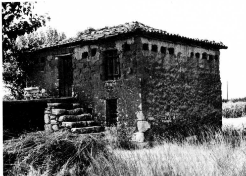
Ενοσωματωμένος σε σπίτι περιστεριώνας, χτισμένος με συμμετοχή από αρχαία αρχιτεκτονικά μέρη, δανεισμένα από τον γειτονικό χώρο της αρχαίας Μαντινείας.
